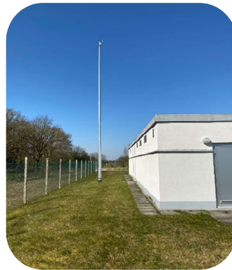
Umspanwerke 10 m Mast
