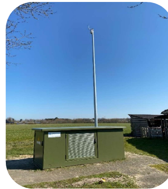
Ortsnetzstationen 8 m Mast
